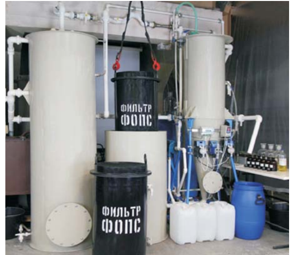
Рис. 1. Внешний вид гидротехнического стенда для испытаний промышленно выпускаемых фильтрующих патронов
