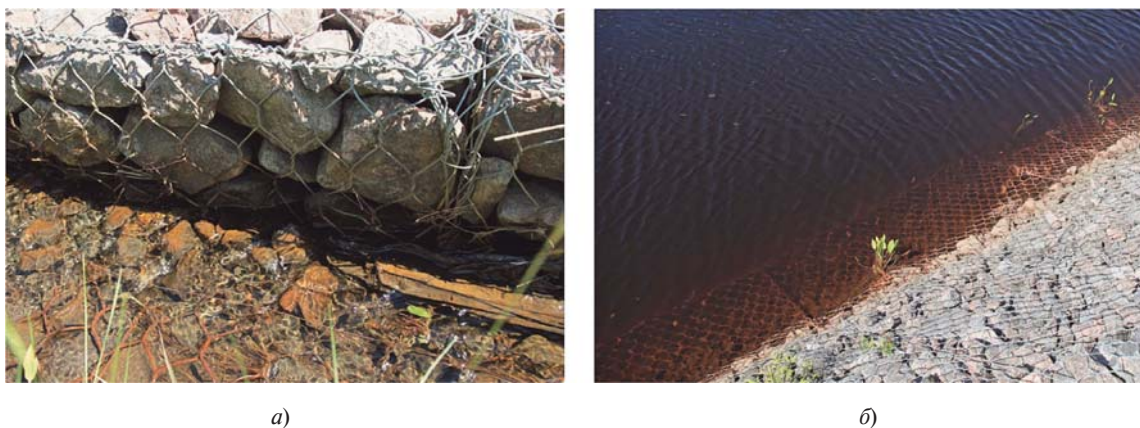
Рис. 7. Коррозия оцинкованных сеток в габионных корзинах при контакте с водной средой: a — габион в основании стенки укрепления склона автомобильной развязки; b — матрацы Рено в нижней части пруда ГБП
