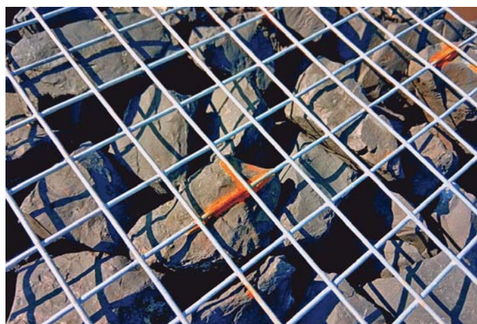
Рис. 8. Внешний вид прокорродировавшей стальной оцинкованной сетки фильтровальной кассеты в ЛОС типа ГБП при контакте с крупнокусковым шунгитом III на КАД СПб
